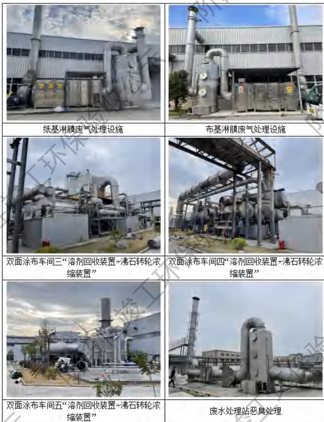
图 4.1-4 有组织废气治理设施
